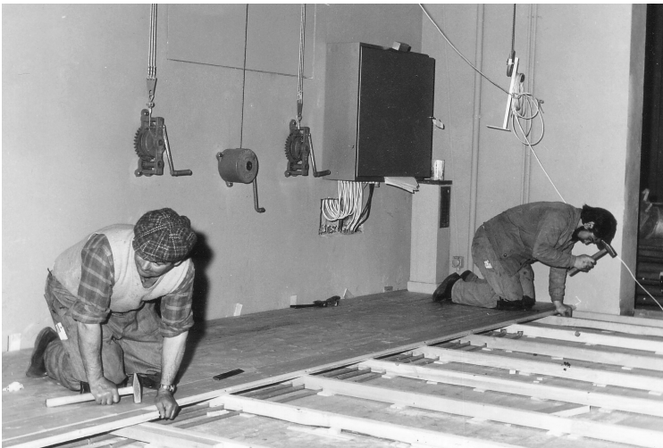
Bernhard Gisi und ein weiterer Mitarbeiter der Firma Fritschi legten den neuen Bühnenboden.
